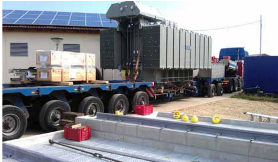
Umspannwerk Bopfingen-Meisterstall - Erweiterung
