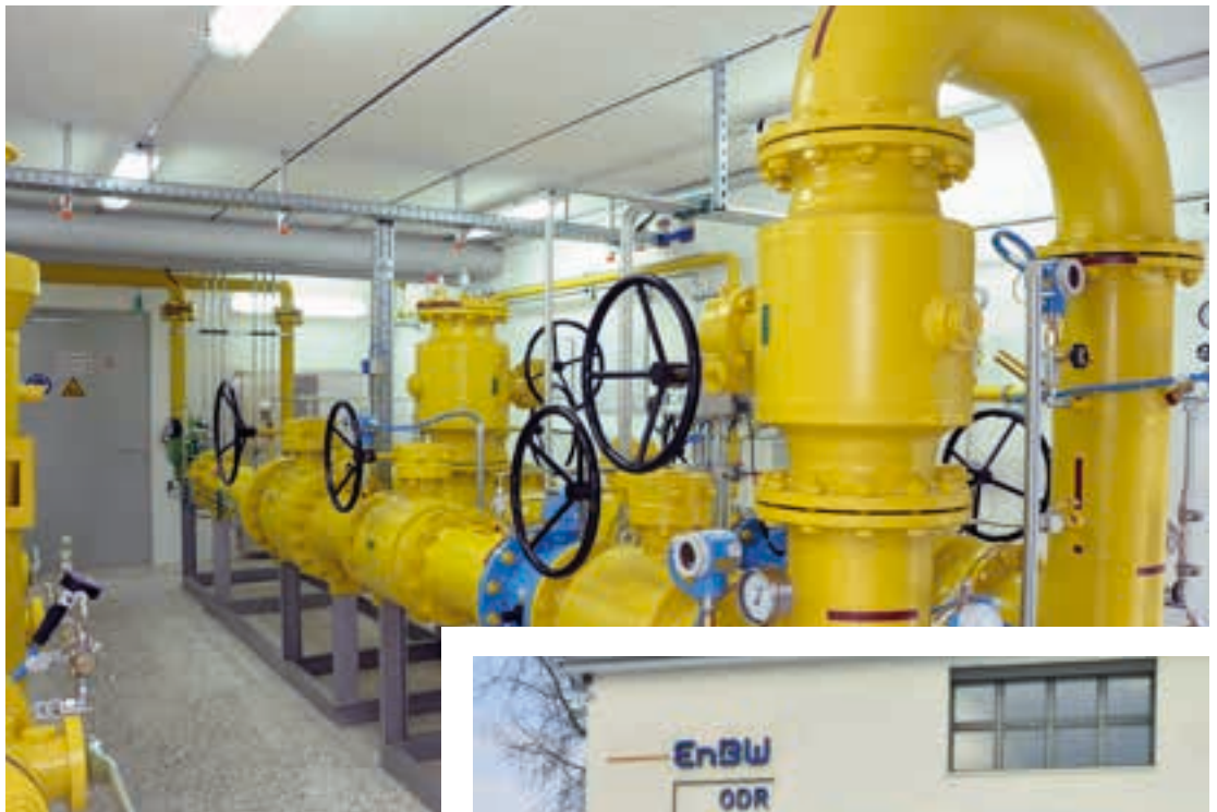
Blick in die Gasdruckübergabestation Gundelfingen
