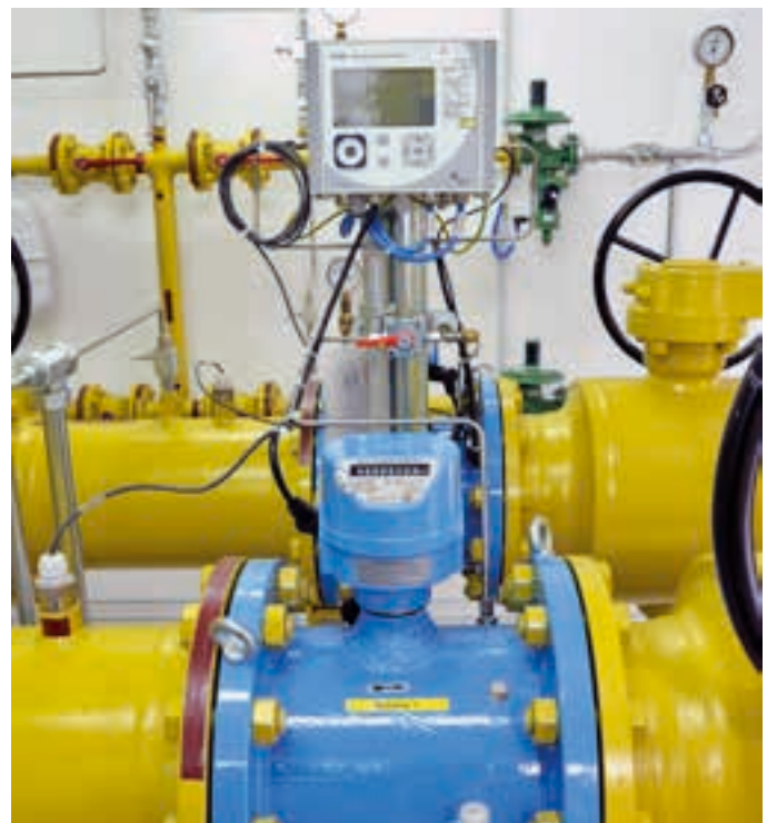
Messanlage für das eingespeiste Erdgas
