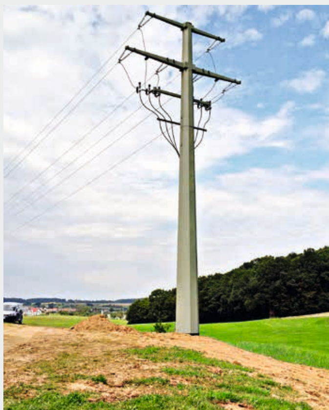
20 kV-Kabelendmast an der B29 bei Mögglingen
