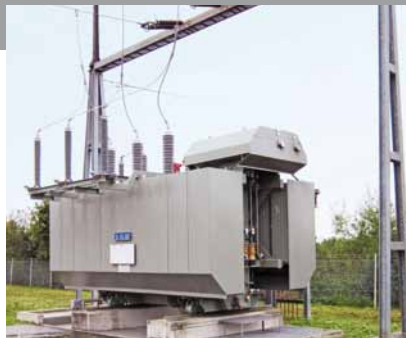
UW Böbingen Trafoaustausch
